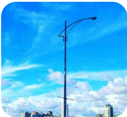
Trụ Đèn Đường
