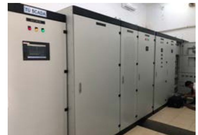
Hệ thống điều khiển Scada, điện hạ thế, chiếu sáng, thông gió hầm Mũi Trâu Scada monitoring system: LV Electrical System, Light Control, Fan/Ventilation for Mui Trau Tunnel
