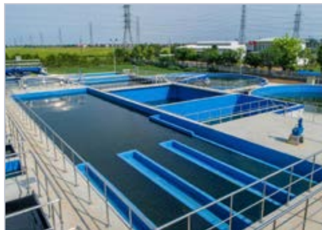
Nhà máy xử lý nước thải Làng nghề Phú Xuyên Water treatment factory - Phu Xuyen craft village
