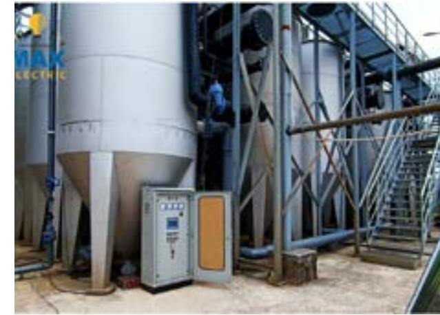
Nhà máy nước sạch Dương Nội - quận Hà Đông Duong Noi Clean water Factory - Ha Dong district
