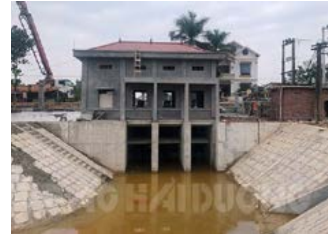
Trạm bơm Hạ Dục - Chương Mỹ Ha Duc pumping station - Chuong My
