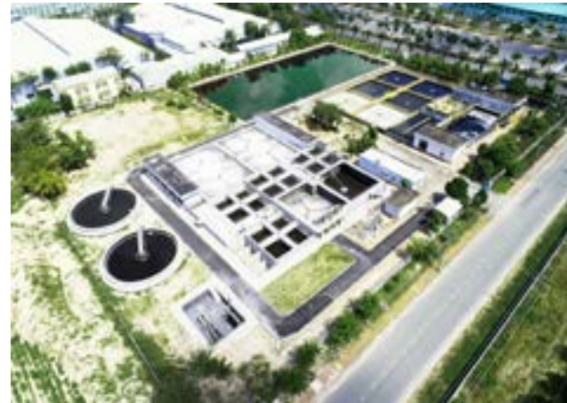
Trạm xử lý nước thải Nhà máy Ohashi Tekko Ohashi Tekko Factory wastewater treatment station
