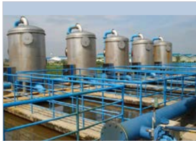
Hệ thống thu gom nước thải TP. Lào Cai Lao Cai Wastewater collection system
