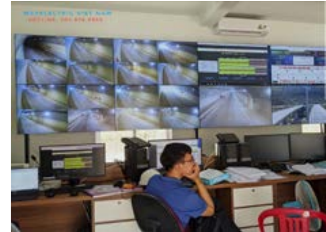
Hệ thống giám sát SCADA hầm Thung Thi SCADA monitoring system for Thung Thi tunnel
