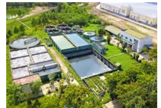
Trạm xử lý nước thải cho tỉnh - tại Myanmar Waste water treatment in Myanmar
